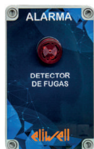
Alarma FG un refrigerante
